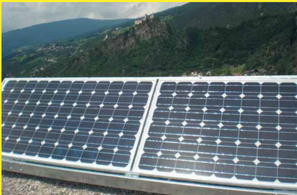
Die neuartige Fotovoltaikanlage der Beton Eisack richtet sich über eine automatisierte Steuerung ständig nach dem Lauf der Sonne.
