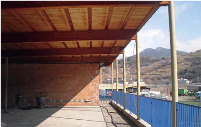
Alcune strutture non sono mai uscite dalla fase costruzione.
