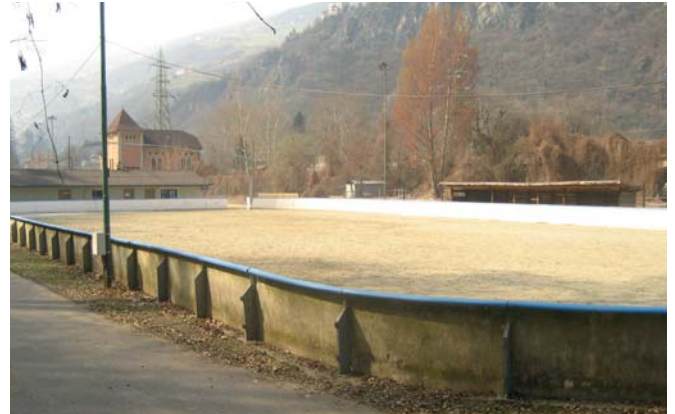
Campo di pattinaggio: struttura con lacune.
