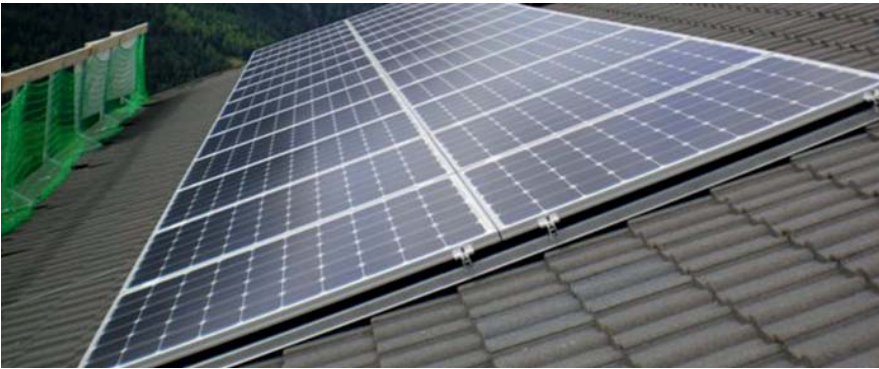
Klausen hat an mehreren gemeindeeigenen Gebäuden Photovoltaikanlagen installiert.
